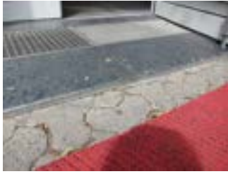
Kleine Schwelle am Haupteingang
